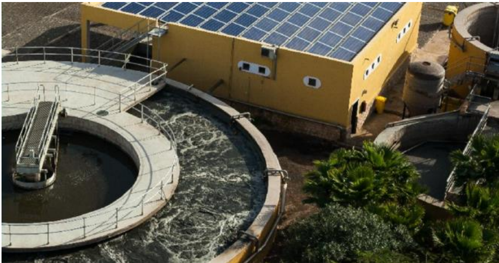
Figura 13 - ETAR alimentado pela instalação solar fotovoltaica de 20 MW.
