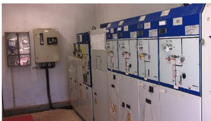
Figura 11 - Interior do centro de interligação elétrica
