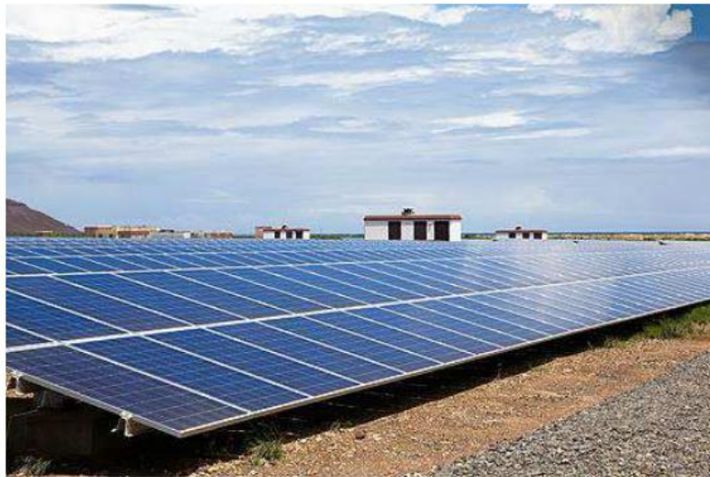
Figura 6 - Central fotovoltaica de Santa Maria (2,5 MW)
