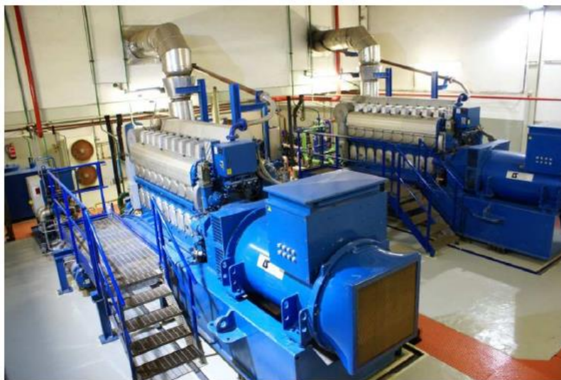
Figura 7 - Central elétrica da APP (5 MW)
